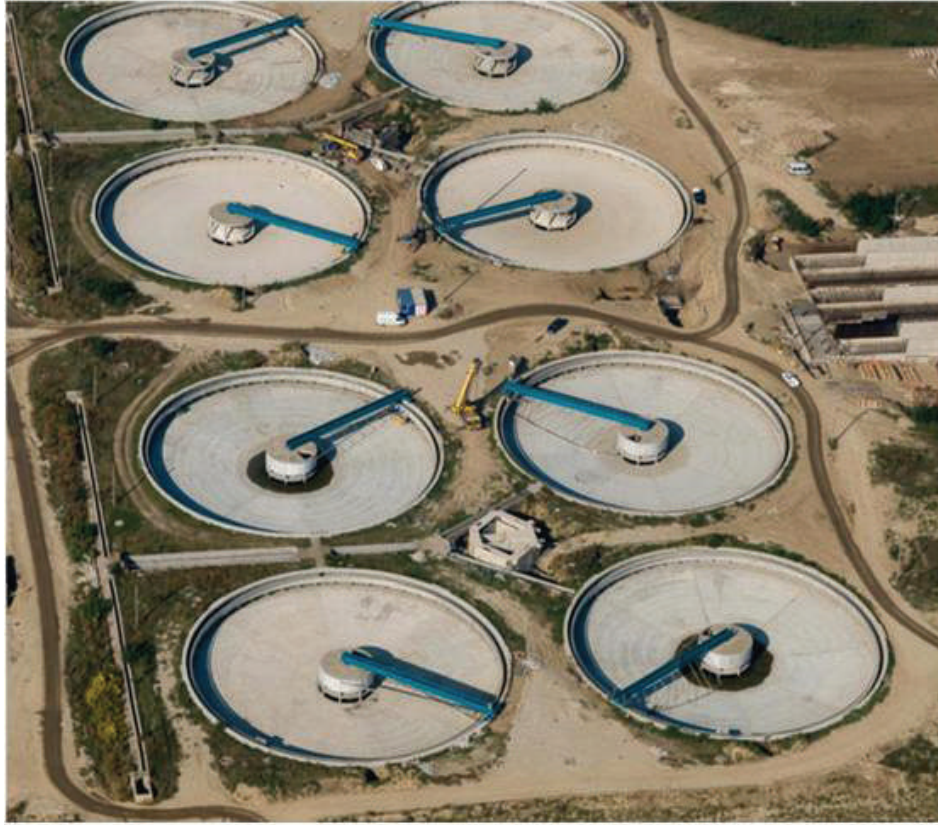
Figura 5. Decantoare primare, diametru exterior D = 55 m - Stația de epurare Glina.
