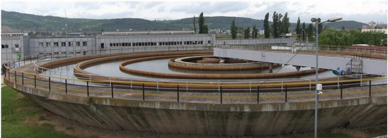
Figura 2. Decantor suspensional cu recircularea nămolului pentru debitul de 1.000 l/s - stația de tratare a apei Chirița – Iași.
