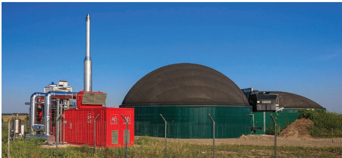
Figura 4. Rezervoare de fermentare cuplate cu gazometre și instalație de cogenerare – Nucet.
